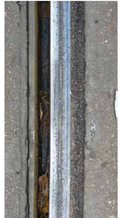
Schmiermittel deutlich neben den Schienen.
