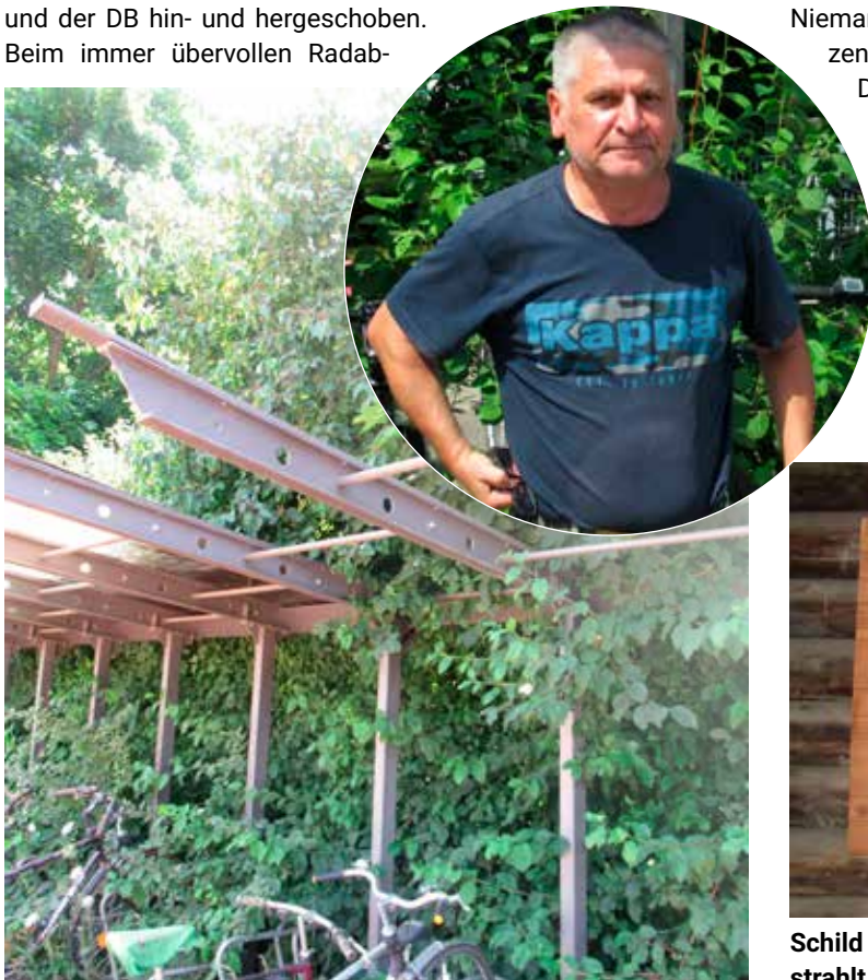
Rundes Foto: Richard Bramowski inmitten von Unkraut am Radunterstand beim Bahnhof. Darunter der beschädigte Radunterstand.
